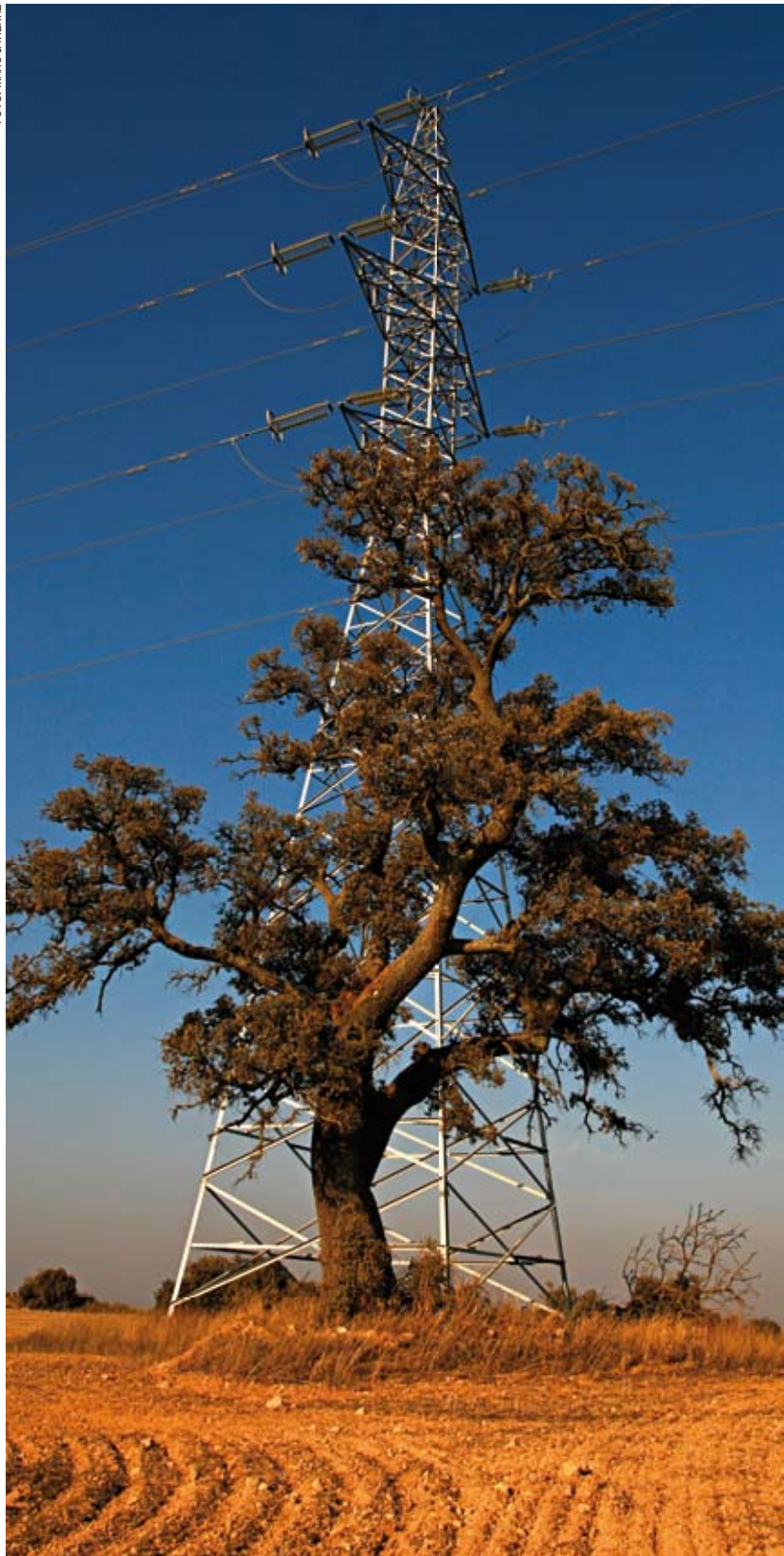
Arbre elèctric, Les sitges, Torà.
